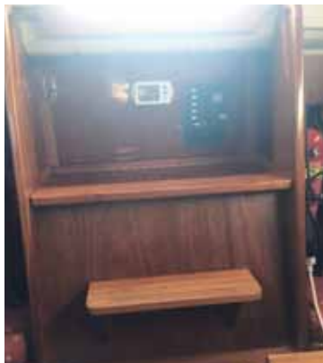
Ny elpanel o batterimätare.
